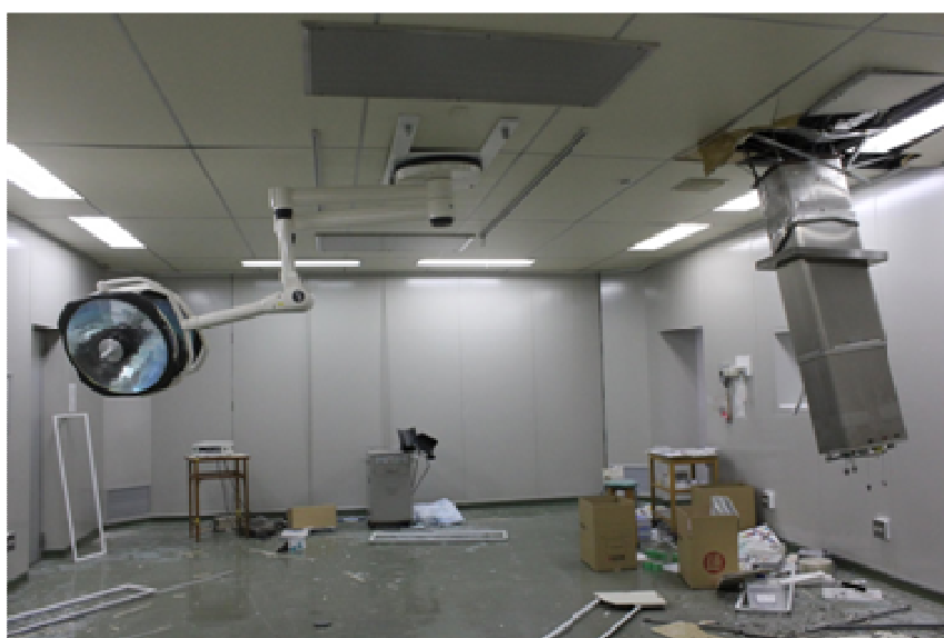
東日本大震災により被災した公立岩瀬病院の旧手術室
